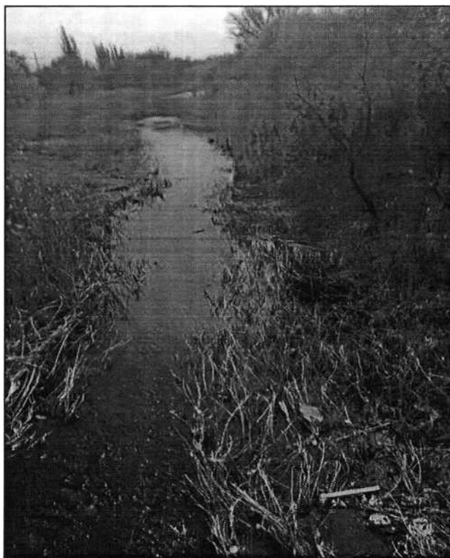
Фото 1.20. Стан русла біля мосту по вулиці Каспійська
