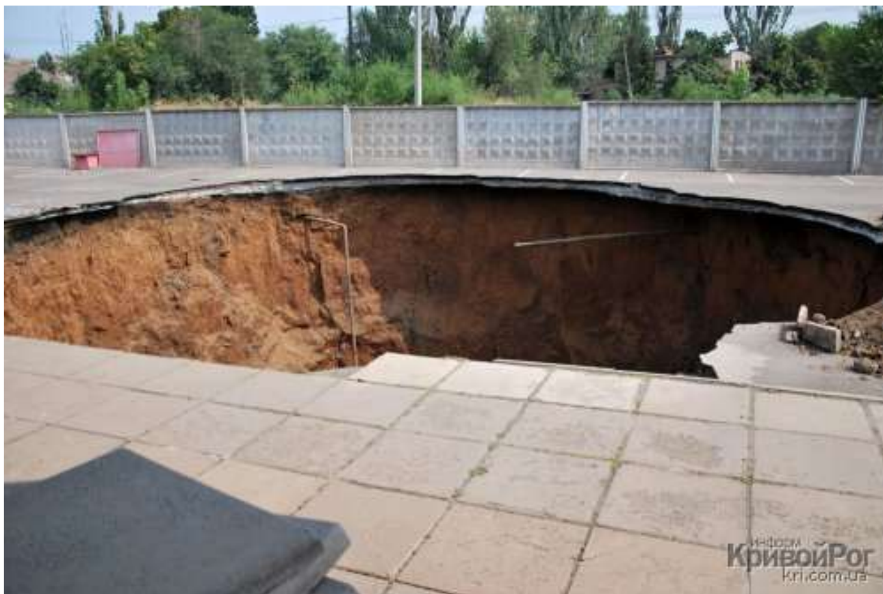
Рис. 1.3. Провал денної поверхні в зоні гірничого відводу шахти «ГПУ»
