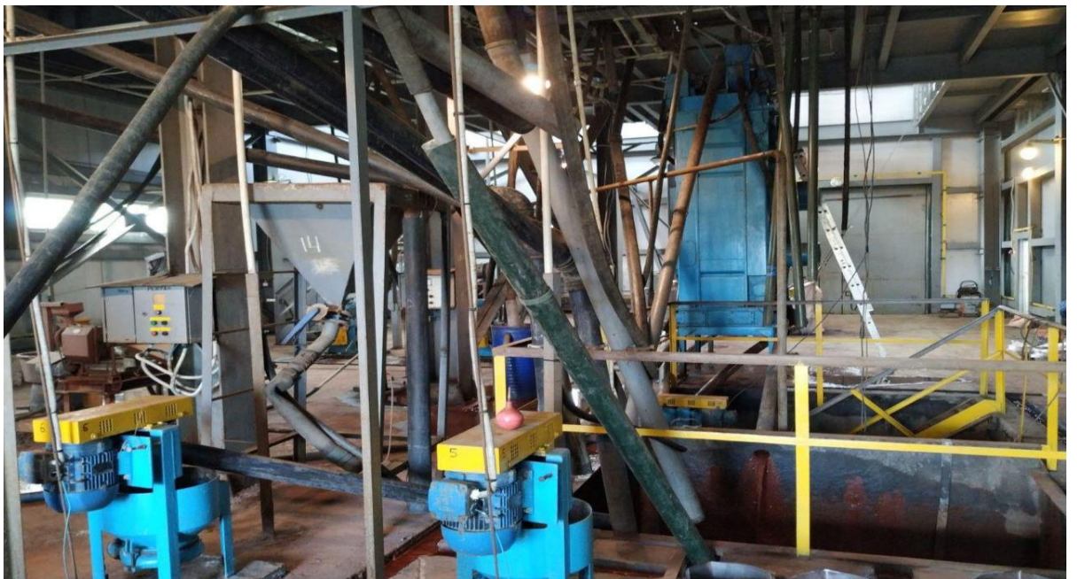
Рис. 2.20. Зовнішня частина установки, змонтованої для проведення випробувань у напівпромислових умовах
