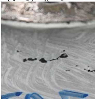
Рисунок 3.11 - Зона зародження тріщини
