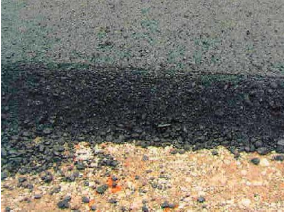
Малюнок 9 Підстилаюче підстава з вторинного щебеню і розріз дорожній одягу автомобільної дороги
