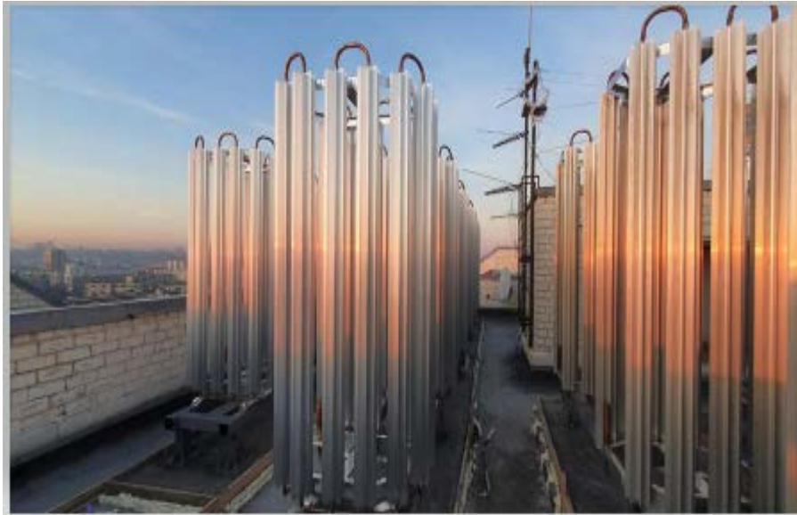
Рисунок 1.7 – Зовнішній блок нового теплового насосу компанії Ostorpus Energy AB
