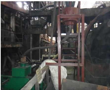
в подача живлення на грохот із пульподільника
