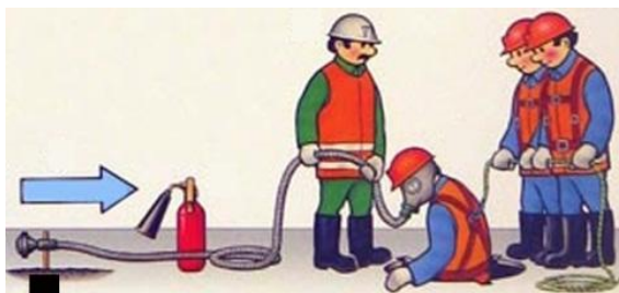
Рис. 8.15. Склад бригади при проведенні газонебезпечних робіт в колодязях, тунелях, траншеях і котлованах глибиною понад 1 м, колекторах і резервуарах
