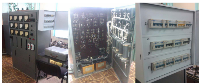
Стенд в лабораторії «Електричні машини» та встановлені на стенді автоматичні вимикачі
