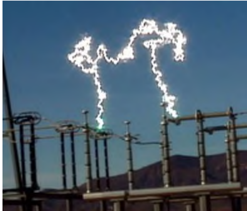
Рисунок 1.9 – Електрична дуга на електропідстанції.
