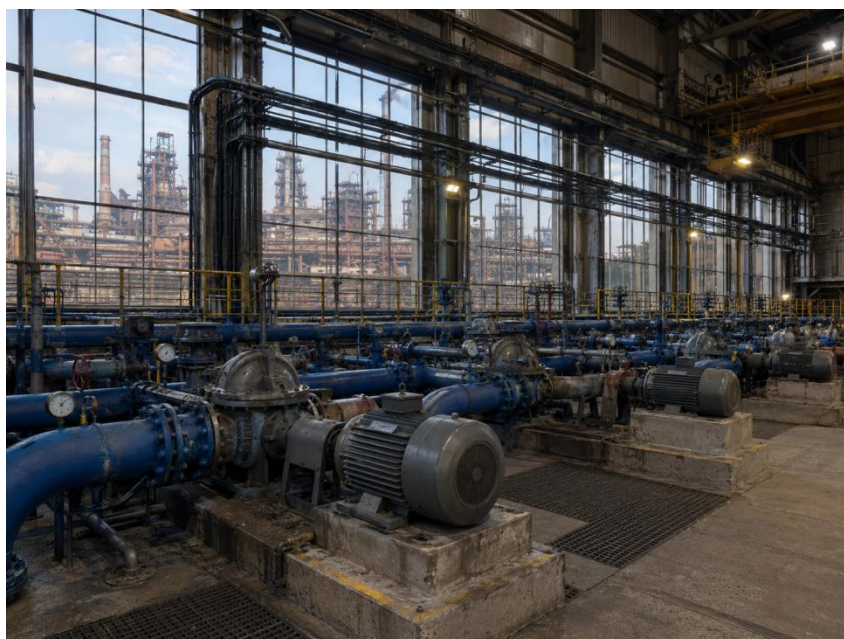
Рисунок 1.1 – Виробнича насосна станція
