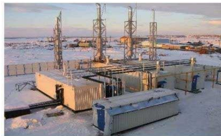
Рисунок 7.5– Блочно-модульна (контейнерна) міні-ТЕЦ
