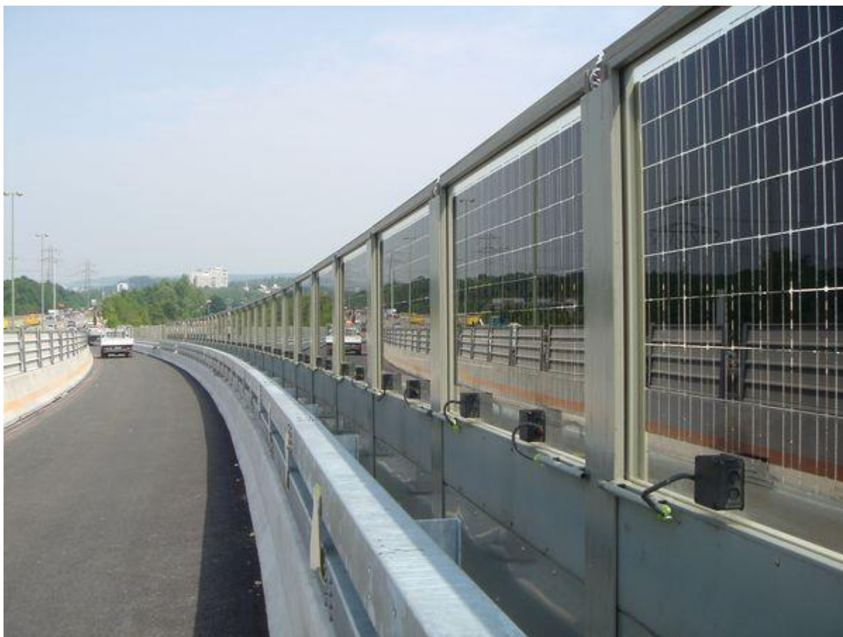
Рисунок 4.6 - Двосторонні сонячні батареї, встановлені на протишумових бар'єрах
