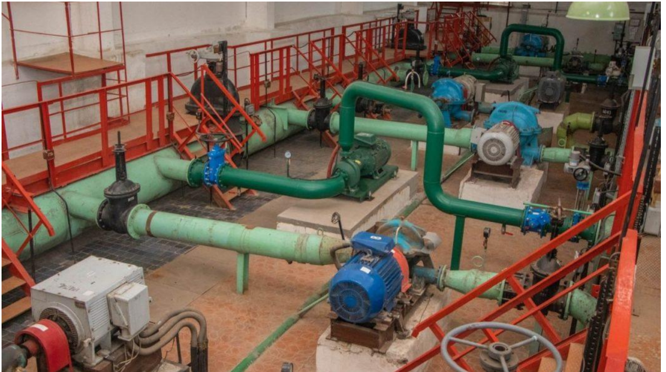
Рисунок 1.1 Фото машинного залу водопровідні насосні станції у одному з районів міста.
