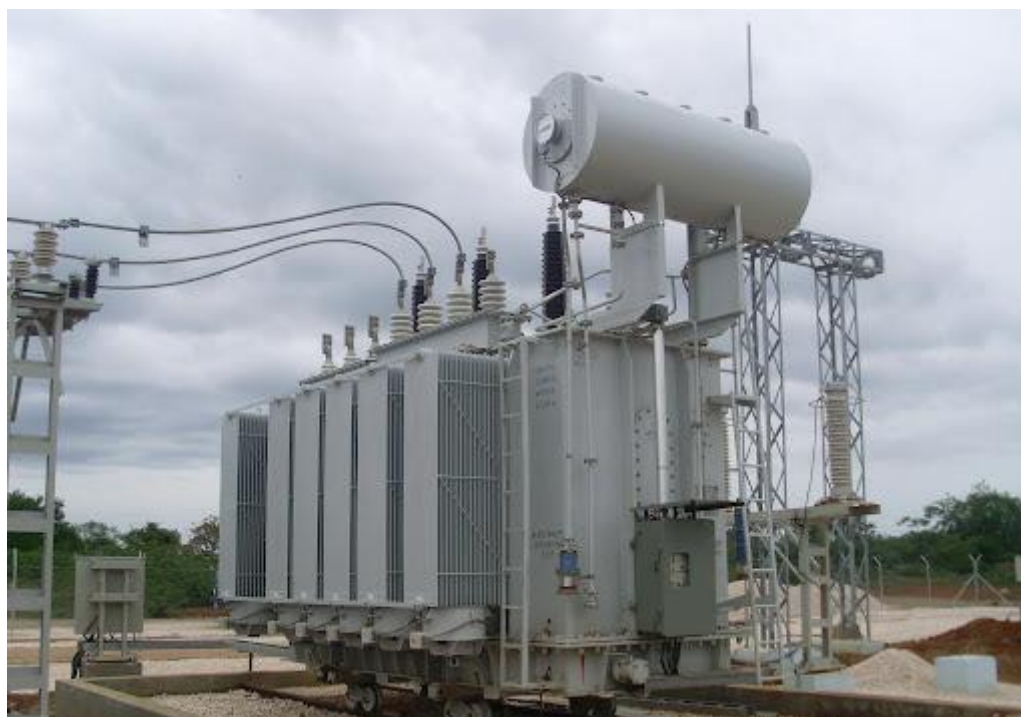
Рисунок 1.2 Загальний вигляд силового трансформатора ТДН-10000/35
