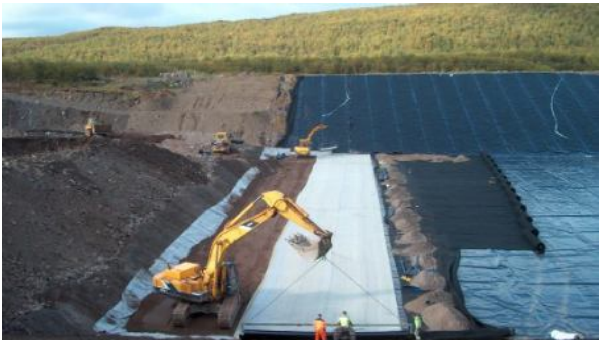
Рисунок 21 - Укладання геотекстилю на дно та укоси відпрацьованого кар'єру з метою подальшої рекультивації
