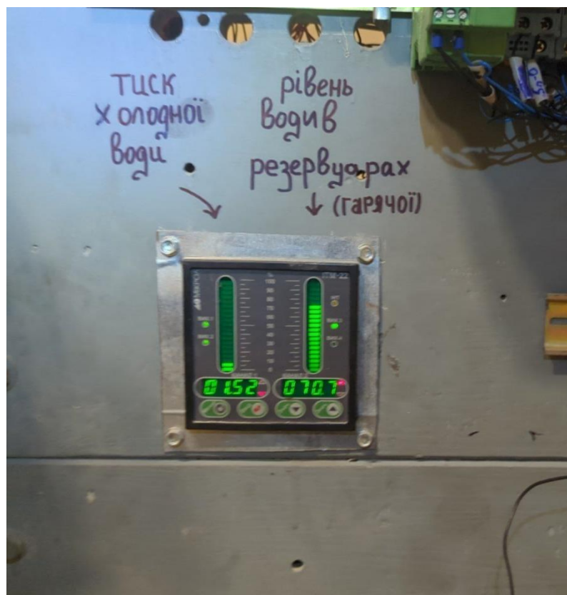
Рисунок 1.10 - Індикатор рівня води в резервуарах: ІТМ-22
