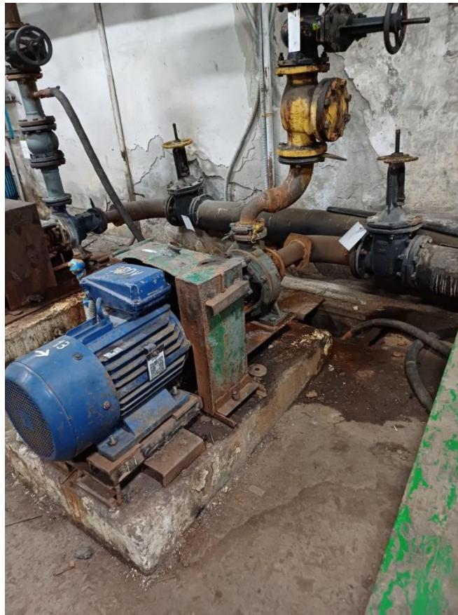
Рисунок 1.11 - Насосний агрегат №1 подачі гарячої води
