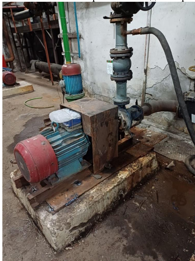
Рисунок 1.12 - Насосний агрегат №2 подачі гарячої води
