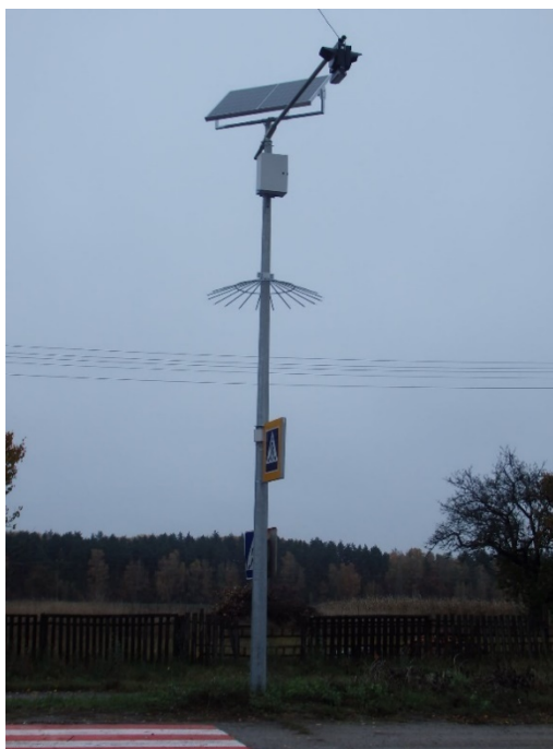
Рисунок 1.5 – “Система захисту” від крадіжки обладнання
