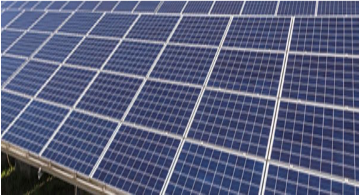
Мал.6 Візуальний стан фотогелектричної сонячної електростанції
