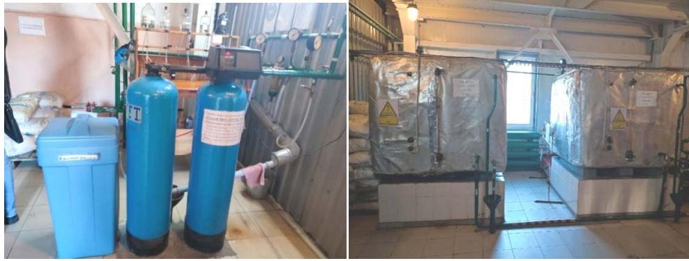
Рис. 2. Система пом'якшення води BWT у котельні
