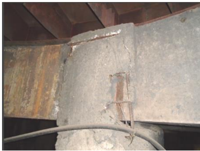
Рис. 5 Найбільш характерні пошкодження кільцевих балок
