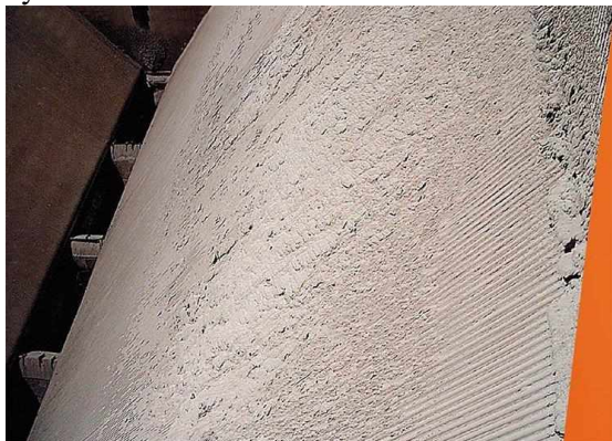
Рис.4. Утворений шлак в топці котла
