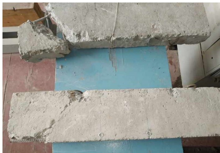
Рис. 4. Залізобетонна балка після руйнування
